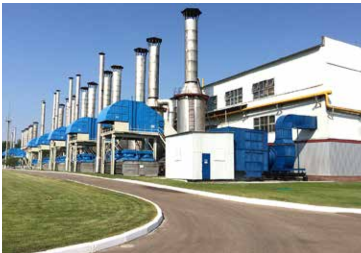
КС-18 Дюртюлинского ЛПУМГ
